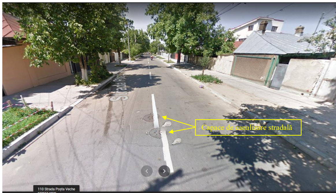
Figura 6. 3 Denivelări ale căii de rulare parcurse la testele 3 și 4 – capace de canalizare stradală str. Poșta Veche [48]
